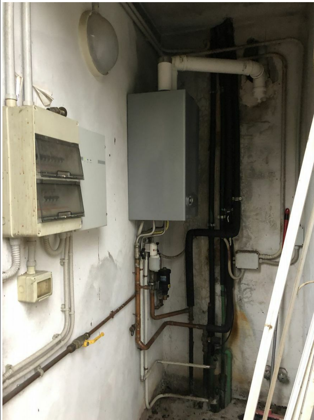
Descrizione: Abitazione - locale caldaia
